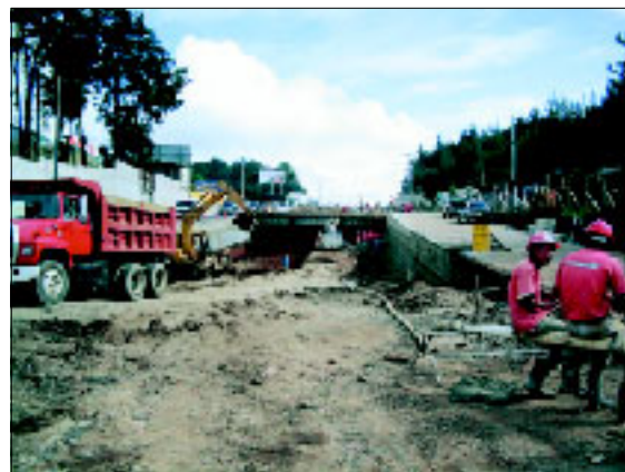
Construcción de distribuidores de tránsito entre los kilómetros 16 y 18.5 de la Carretera Interamericana CA-01
